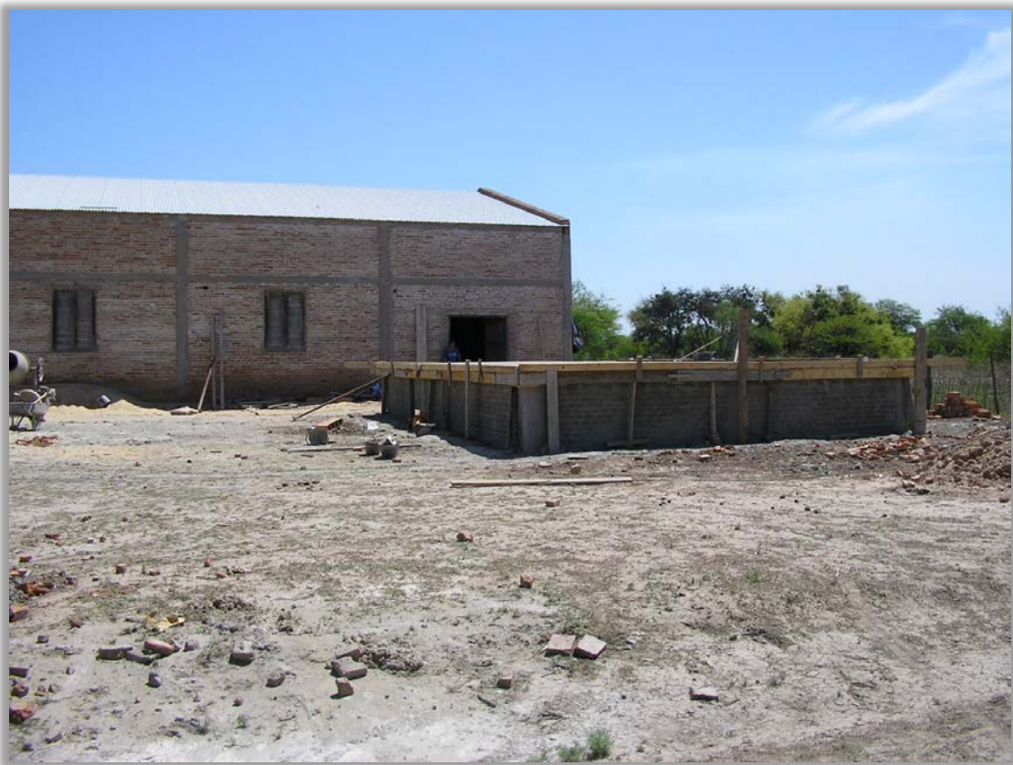
Figura 5.18. Aljibe comunitario Norte Santafesino.
