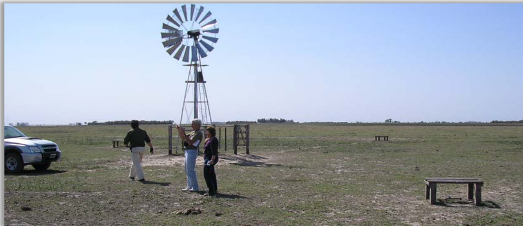
Figura 5.57. Molino y pozos de recarga-bombeo.
