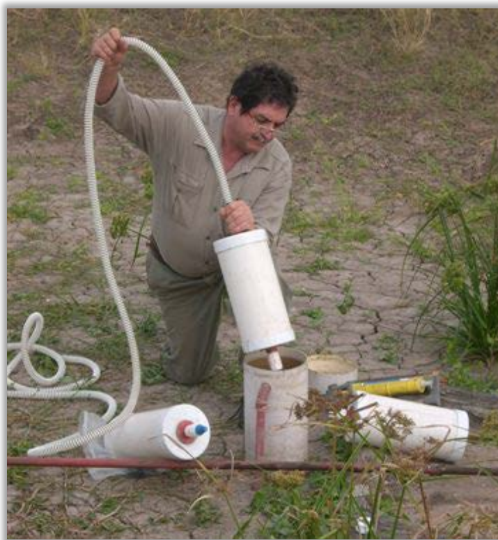
Figura 5. 36. Instalación de Flotante con la manguera de aspiración.
