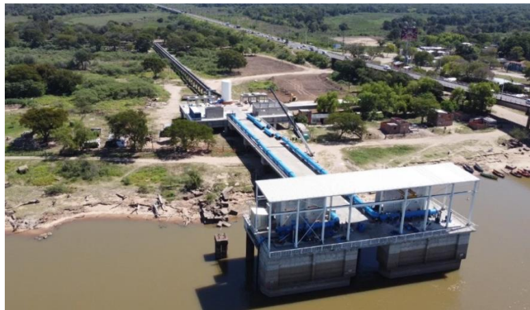
Localidad: Resistencia Nombre Toma: Toma del Segundo acueducto SAMEEP
