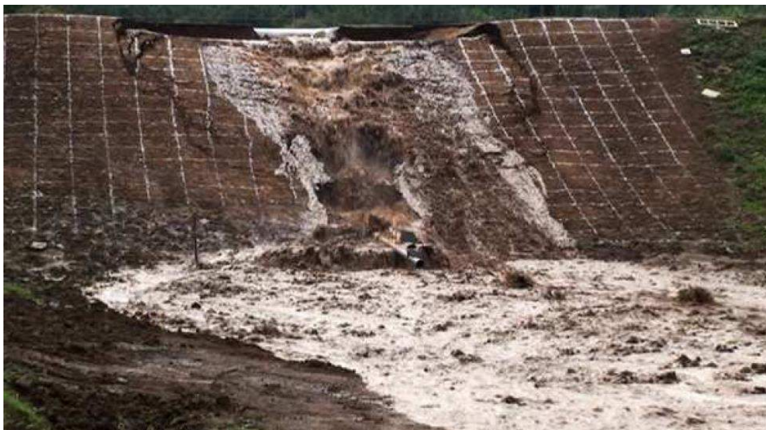
Figura 6.4.2 Desestabilización del talud de la presa.
